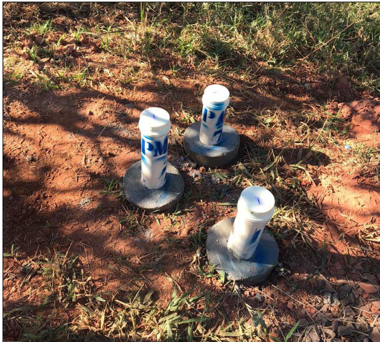
Foto 16 – Poços de monitoramento de gases e água subterrâneo instalados
